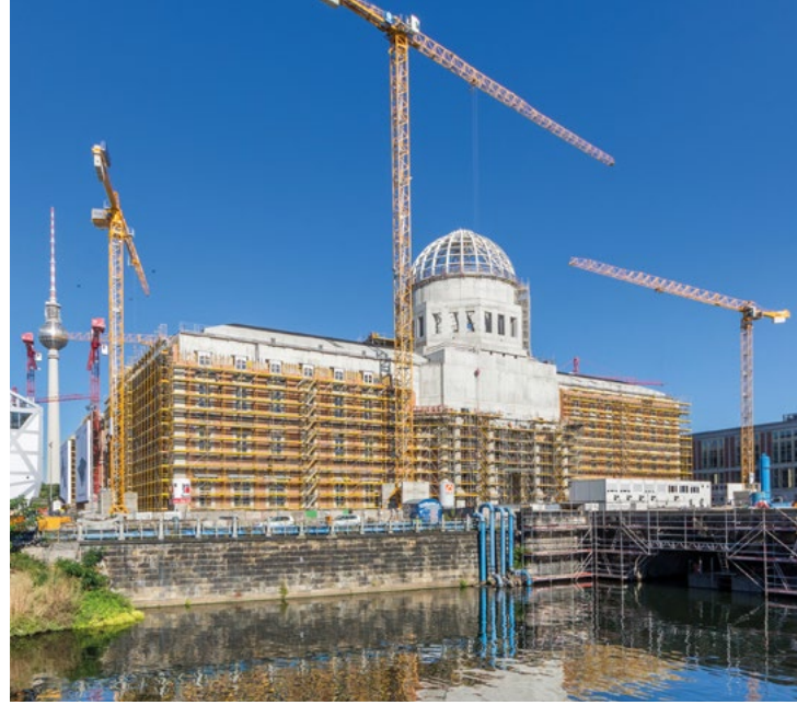
Aktuell rüstet Kieback&Peter das komplette Berliner Stadtschloss mit Gebäudeautomation aus.
